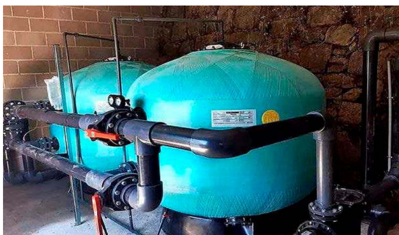
Depuradora de la piscina municipal de El Real de San Vicente.
