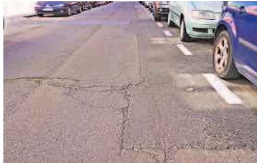
La calle Fresno parcheada a causa de los reventones. LAYA
