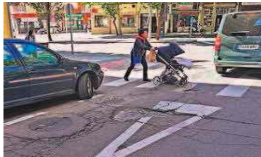
Calzada con baches y roturas en la calle Fresno en Garrido. LAYA
